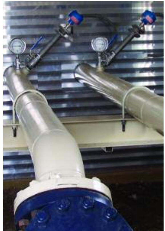
Der Erdgasdurchfluss in einer Gasförderanlage wird überwacht, damit der Durchfluss jeder einzelnen Quelle gemessen werden kann. Der Hauptüberwachungs-Übertragungsmesser ist hinter dem Zusammenfluss der einzelnen Leitungen positioniert.
